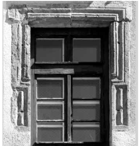
Ryc. 2. Fasciowe obramienie okna pierwszego piętra fasady kamienicy przy ul. Jasnej 2, fot. autor, 2010
